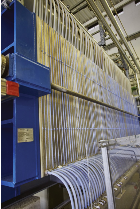
Bild 1.2 Alkalische Elektrolyseanlage (AEL) der ela Industriegas GmbH zur Erzeugung von Wasserstoff im emsländischen Werlitz © ela Industriegas GmbH
