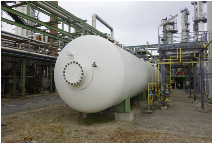
Bild 2.1 Speicherbehälter für Wasserstoff in einer chemischen Anlage © H&R ChemPharm GmbH
