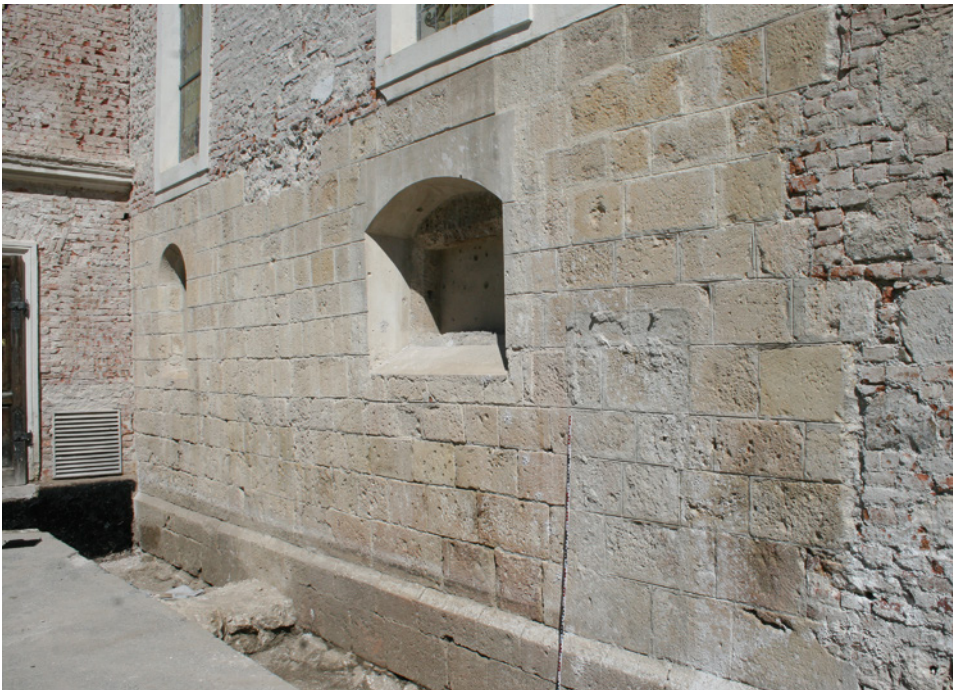
Abb. 29: Schwarzau am Steinfeld, Pfarrkirche. Südfassade des Kernbaus aus dem zweiten Viertel des 13. Jahrhunderts.
