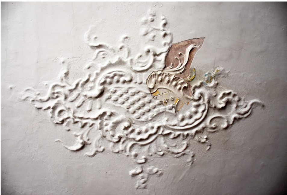
Abb. 10: Straßburg Stadt, Pfarrhof Lieding. Detailaufnahme des teilweise freigelegten zentralen Stuckfeldes in Raum 1.05.
