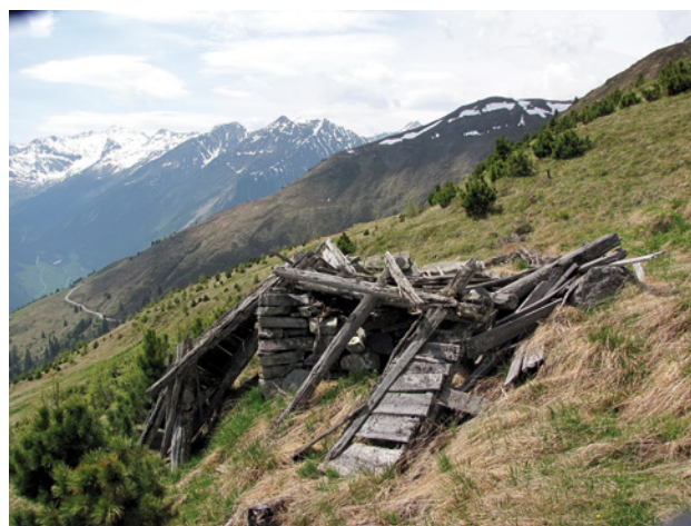
Abb. 165: Verfallene Kochhütte am Sellrainer Sonnberg (Blick nach Südwesten).
