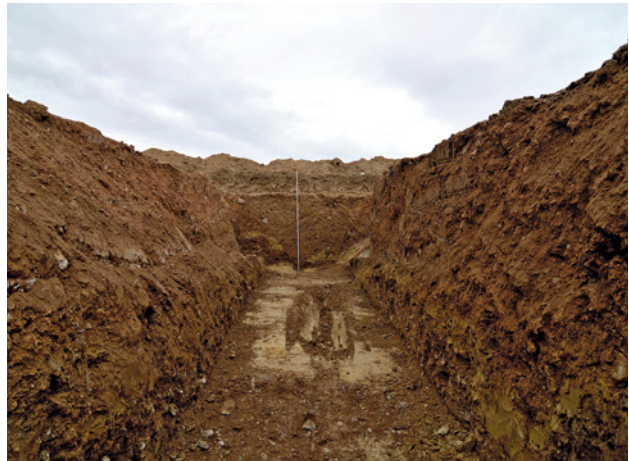
Abb. 5: Aufnahme von Sohle und Profil des Panzerabwehrgrabens in der Nähe des Kreuzstadls.
