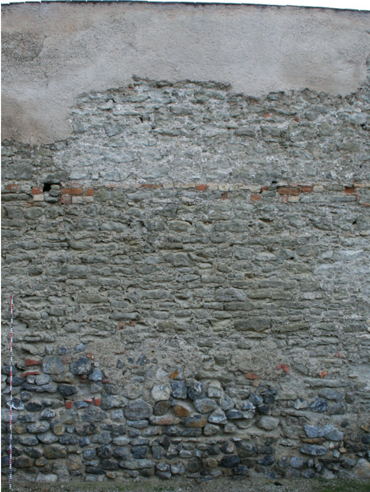
Abb. 9: Großenzersdorf, Stadtbefestigung. Primäres Kompartimentmauerwerk der Stadtmauer mit Ziegelabschluss auf der Höhe des ersten Wehrgangs, darüber die Aufzonzung um 1400 (Gst. Nr. 27/2); unten Ausbesserung des 20. Jahrhunderts.
