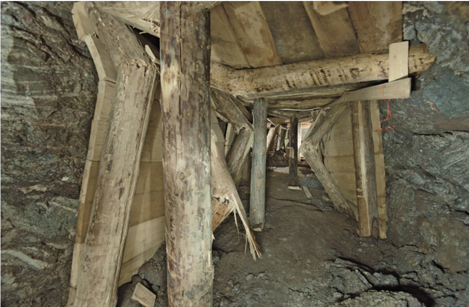
Abb. 22: Hallstatt (OÖ.). Zustand des Enderwerk-Rutschenschurfes vor Beginn der Instandsetzungsmaßnahmen 2017.
